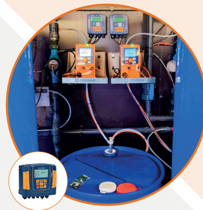
Doseerpomp met pH-controle
